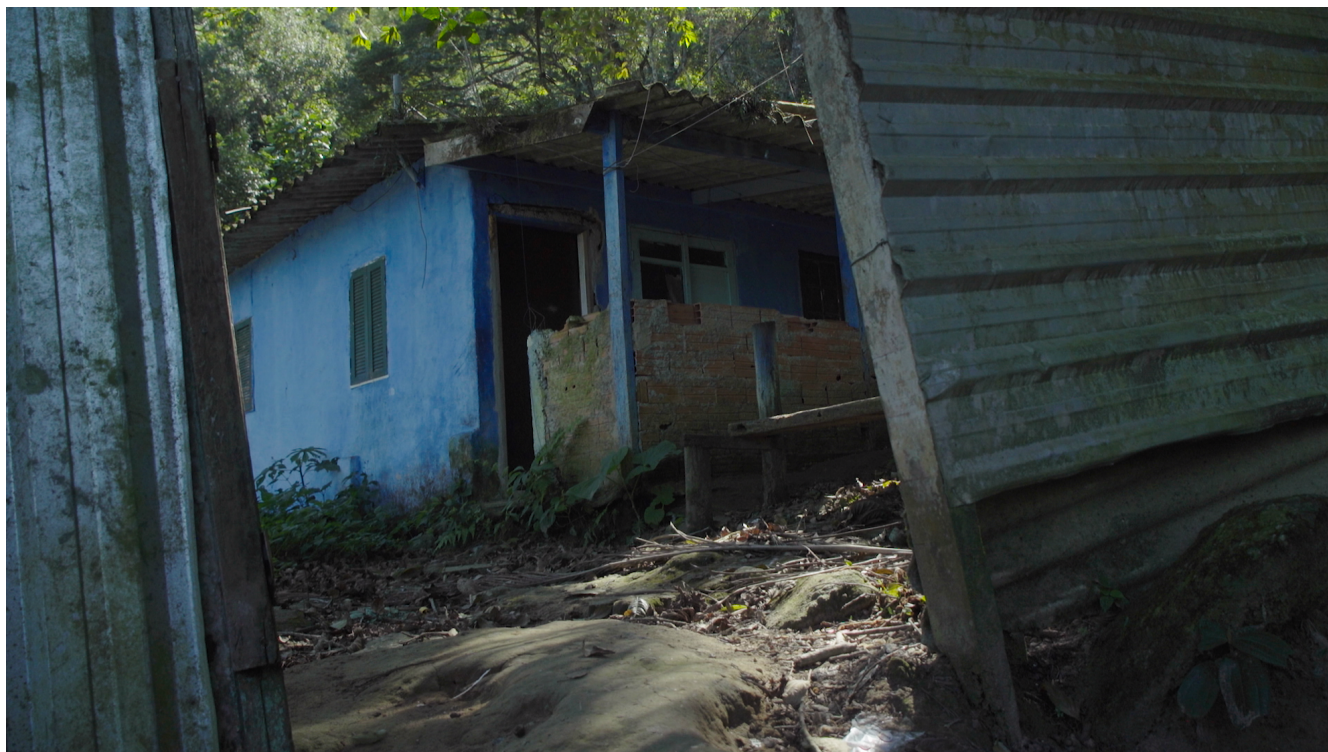
Moradia em área de risco na comunidade Vila Pantanal/Foto Ed Davis
